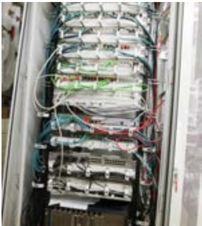
Bild oben: Als Beispiel sieht man hier die Netzwerkverkabelung für den Historischen Altbau.
