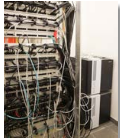
Bild oben: Die Haupttelefonanlage.
